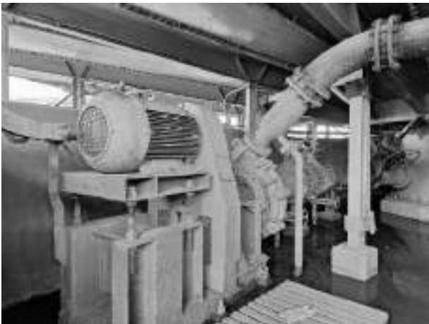
Figura 21 - Bombas Underflow Espessador
