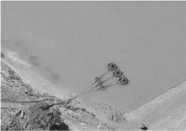
Figura 49 - Bombas Água Processo
