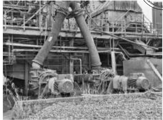
Figura 16 - Bombas de Descarga do Moinho
