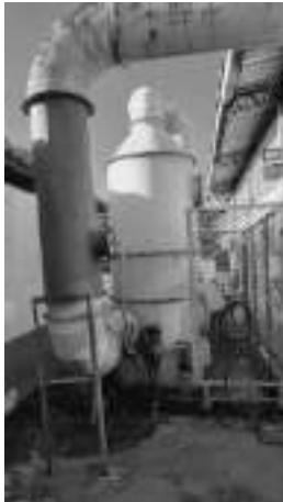
Figura 57 - Lavador de Gases
