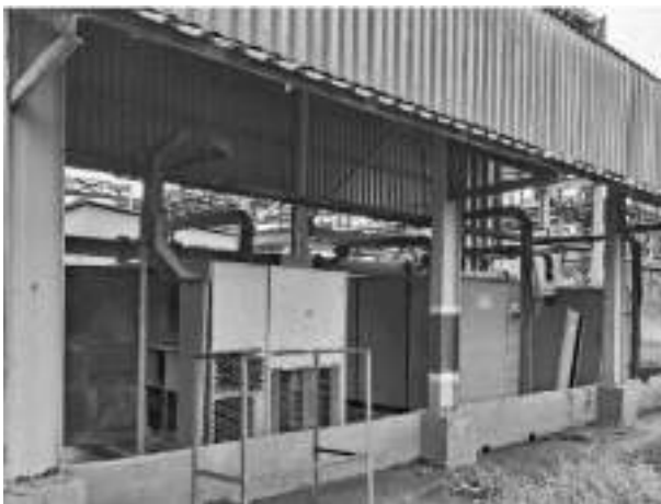
Figura 68 - Compressores de Ar
