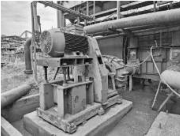
Figura 19 - Bombas Underflow Peneira Moagem
