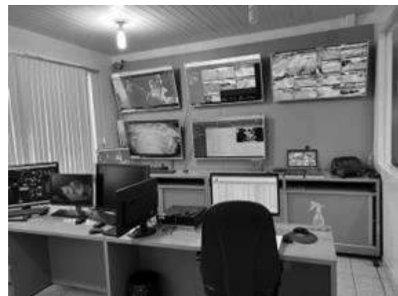
Figura 76 - Manutenção e sala de controle (2)
