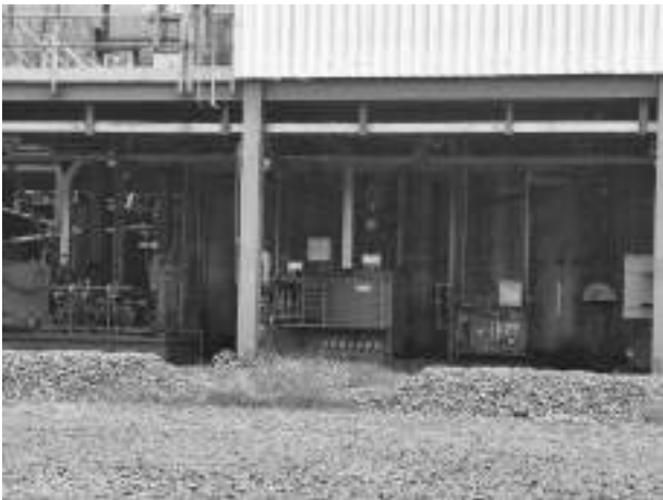
Figura 15 - Unidade Hidráulica Moinho Bolas
