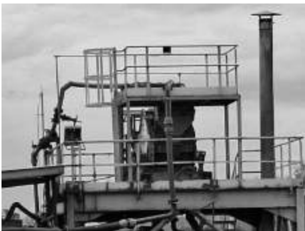
Figura 45 - Peneira Desaguamento Eluição
