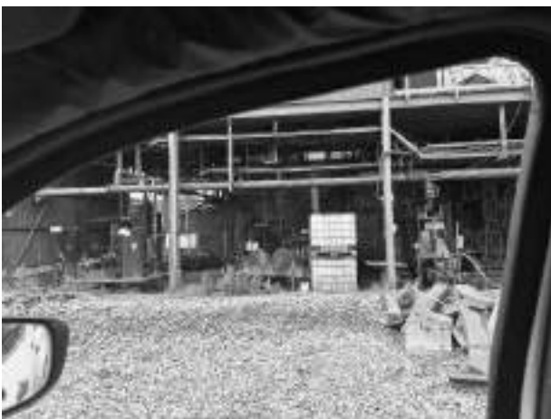
Figura 14 - Unidade Hidráulica Moinho SAG
